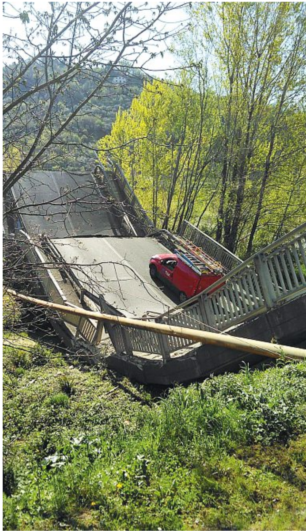
Intrappolato Un furgoncino rimasto adagiato sulla striscia d'asfalto che ha ceduto ieri
