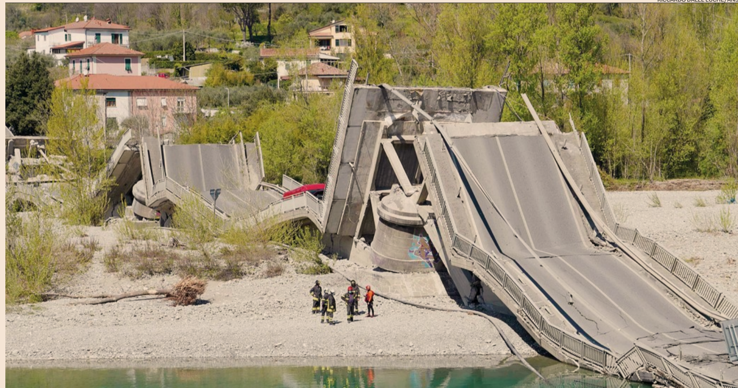
Cedimento. Il ponte crollato sul fiume Magra nei pressi di Aulla (Massa Carrara)
