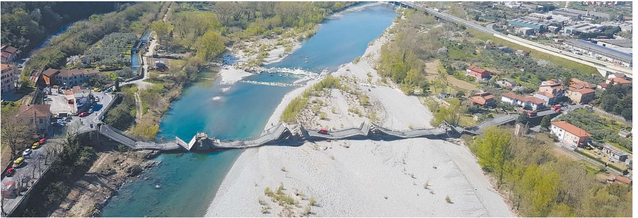
L'impressionante immagine del ponte di Capriogliola, che collega le province di La Spezia e Massa, subito dopo il crollo: la Procura di Massa ha sequestrato l'area e aperto un'inchiesta
